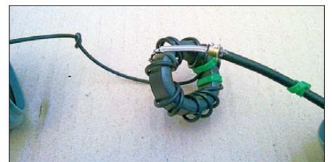
Bild 4: Breitband-Spartransformator mit Kabelbinder am RG58 zur Zugentlastung
